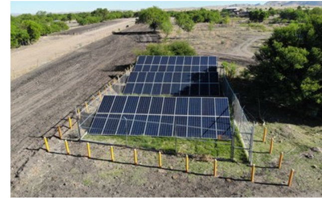
Solar panel – pumping well San José del Sitio
